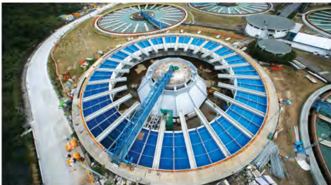
沙田濾水廠加速澄清池斜管
